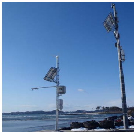
東松島市津波監視システム施工例 HOPE協働、東松島市発注
