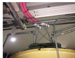
③けん化前の精油タンク 投込みコイル 1/2フレキ 10m×3本並列 400φ
