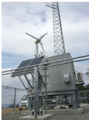
石巻漁業協同組合漁業無線局 バックアップ電源として活用
