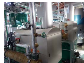
バイオマスボイラ発電
